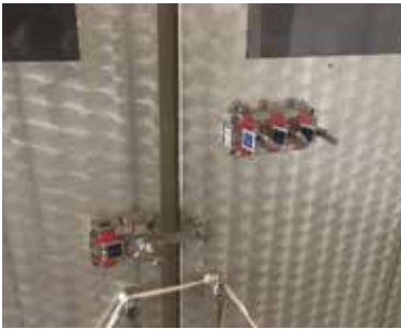
开关柜钥匙交换盒和门锁
